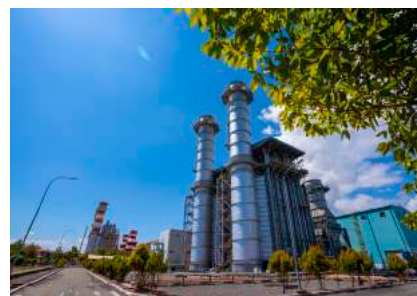
Nhà máy điện Nhơn Trạch 1 (Đồng Nai)
