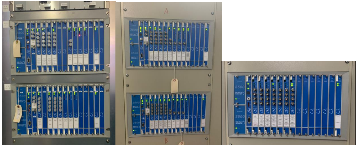
Hình 2. Hệ thống giám sát BN3500 cho Tuabin – Máy phát và Bơm cấp
