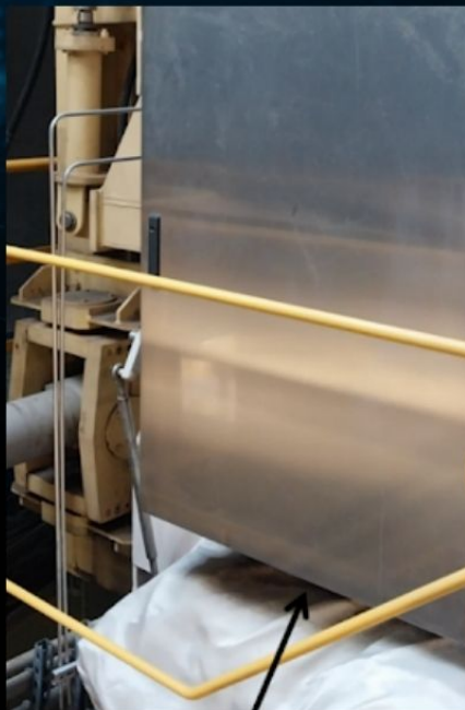
Vị trí dây cáp bị cháy trước khi bị cháy
